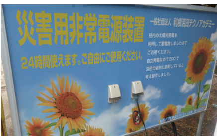
災害時非常用電源
